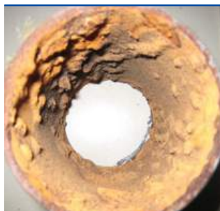
Antes de la instalación (Agosto 18, 2007)
