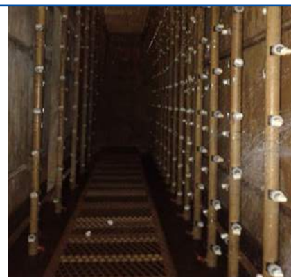
10%Pulverizar capacidades debido a inyectores obstruidos
