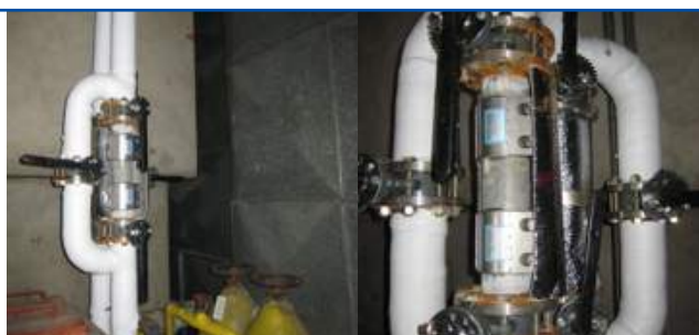
Instalación en punto de inspección
