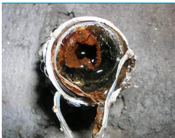
El tubo está casi obstruido con escama.
