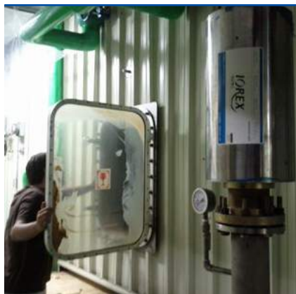
Unidad de tratamiento de aire con IOREX (100A)
